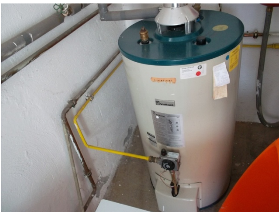
Direkt beheizter Warmwasserspeicher
