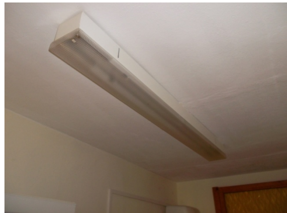
Beleuchtung (exemplarisch), ineffiziente T8-Lampen (KVG) in Gehäuse mit diffuser Lichtverteilung
