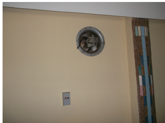
Konservative Lüftungsanlage im Hauptsaal
