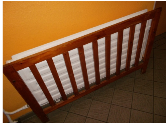
Plattenradiator (Standardheizkörper im gesamten Objekt)
