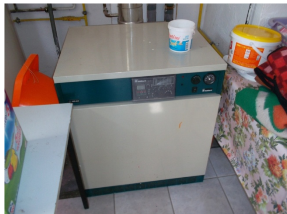
Gas-Heizkessel ohne Gebläse von 1991
