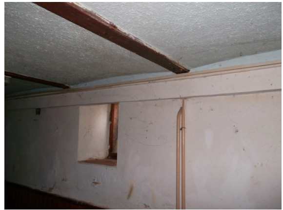
Kellerdecke ohne Wärmeschutz
