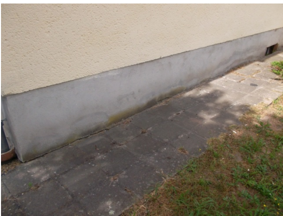
Feuchteschäden im Kellerdeckenbereich
