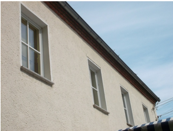
Keine Dämmung der obersten Geschossdecke sowie der Fassade; Wärmeschutzverglasung
